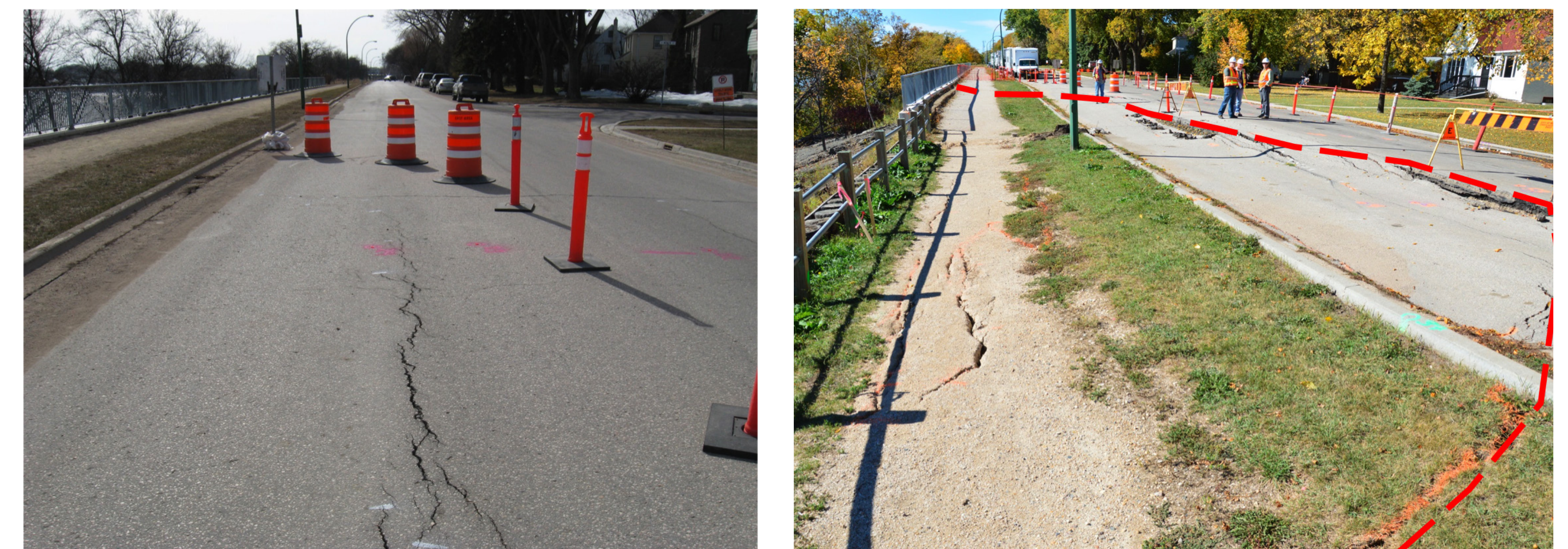
INSTABILITÉ DE LA RIVE – DE L'AVENUE MONCK À L'AVENUE TACHÉ
