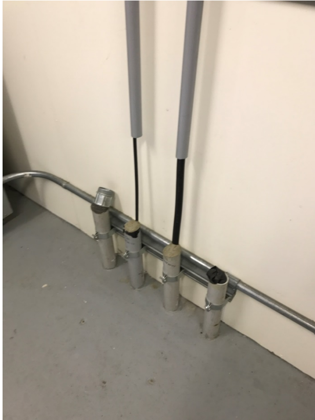
Photo 9 - Electrical Shed Conduits
