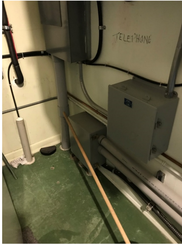
Photo 11 – Electrical Panel Conduits
