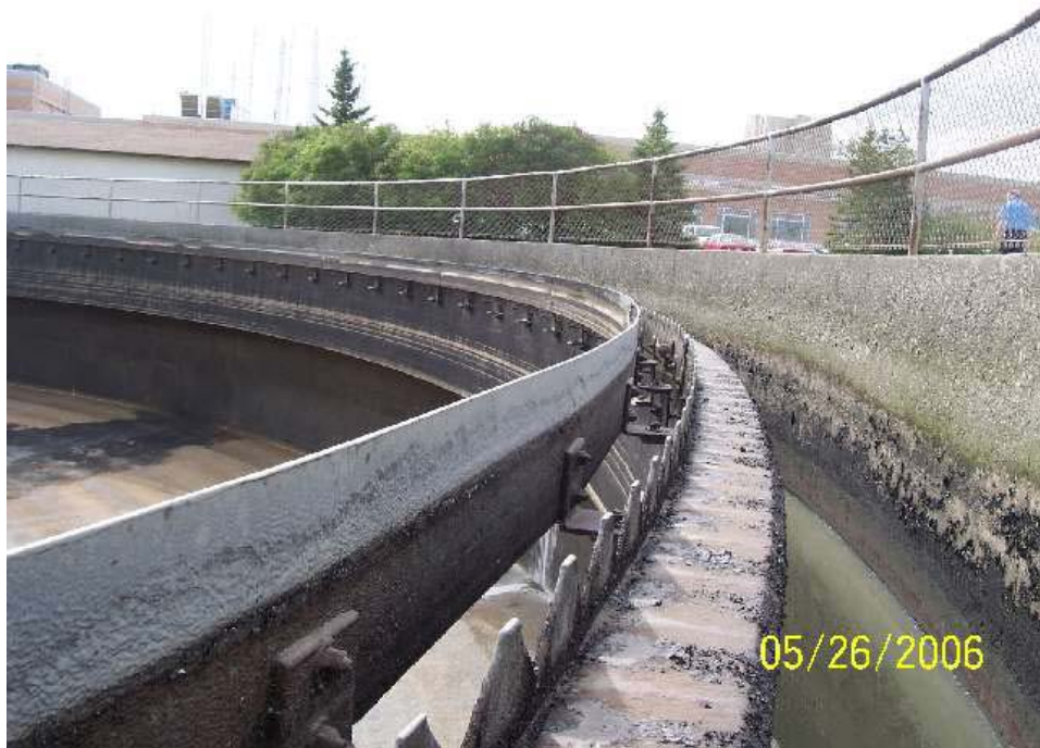
Photo 3-6 Effluent Weir & Launder
