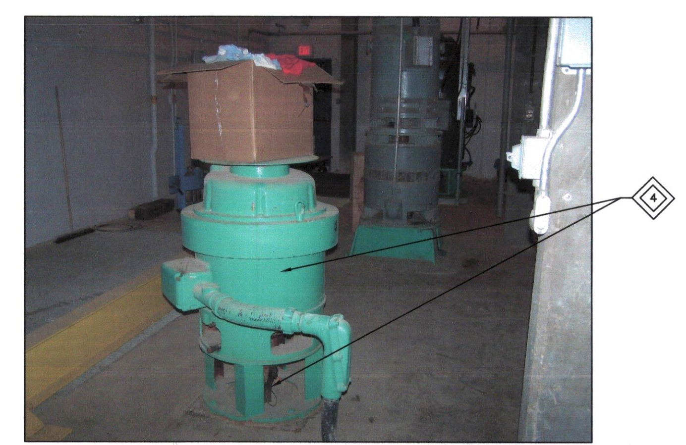
9 P3 PUMP MOTOR - LEVEL 300 M1
