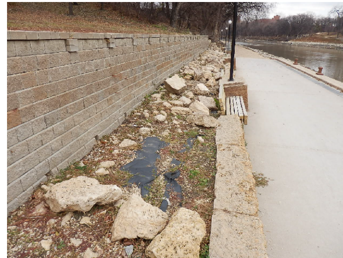
2 EXISTING PHOTO - MISSING RIP-RAP L4 Scale: 1:200
