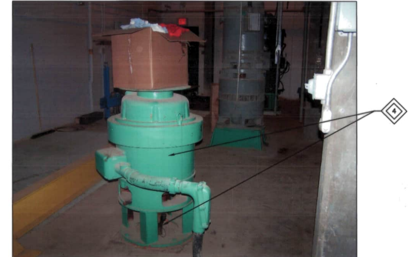
9 P3 PUMP MOTOR - LEVEL 300 M1
